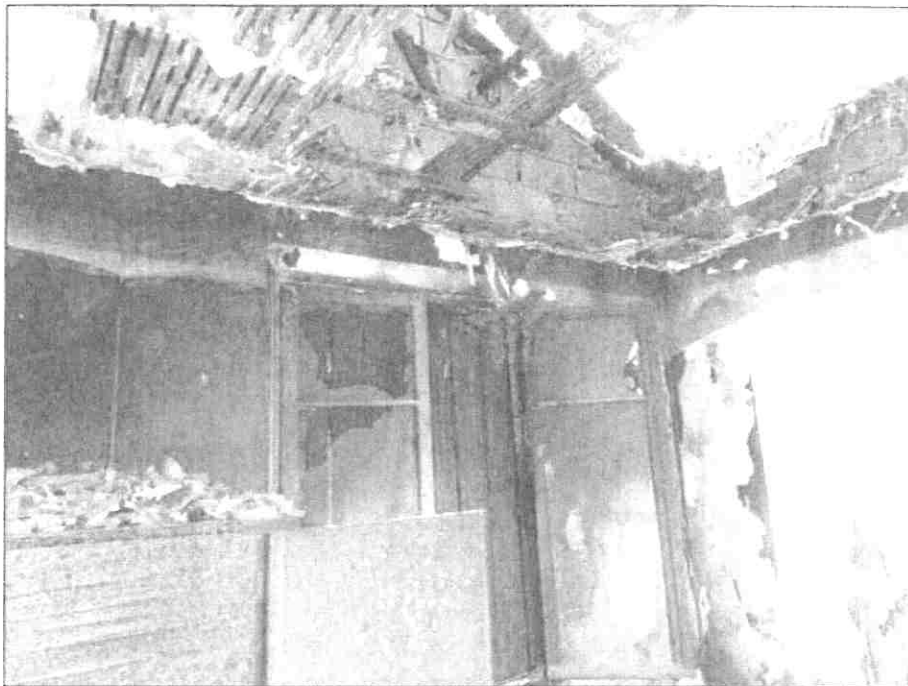
Vue d'une chambre de la maison après l'incendie.
