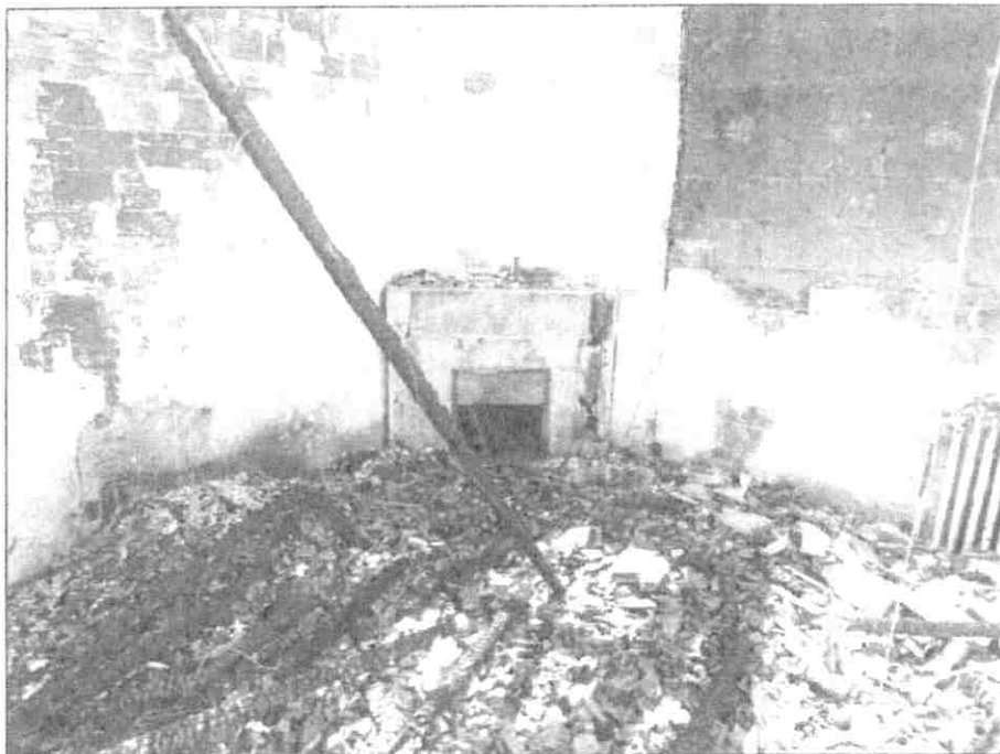
Vue du séjour de la maison après l'incendie.
