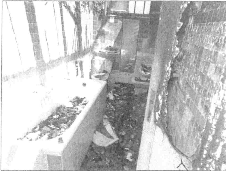
Vue de la salle de bains de la maison après l'incendie
