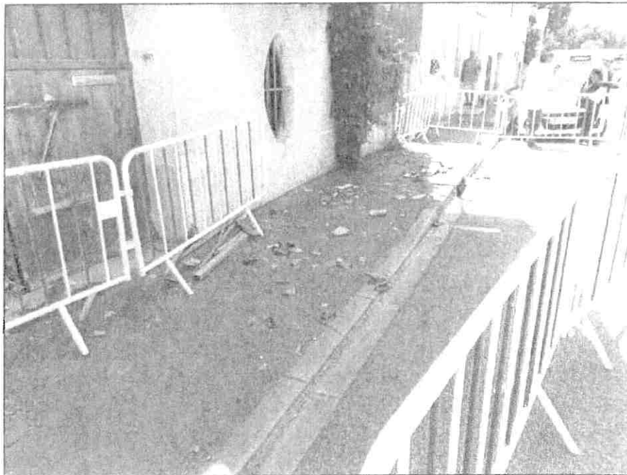
Des éléments de couverture ont été emportés par le vent sur le domaine public.
